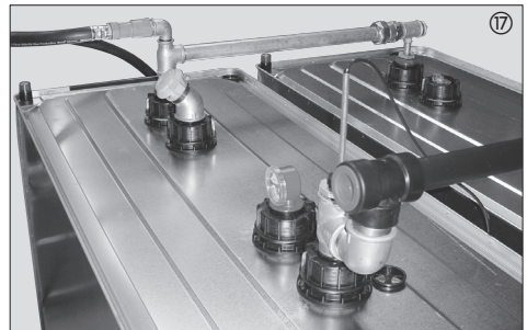
⑰ Fertig montierte Batterieanlage von hinten.
